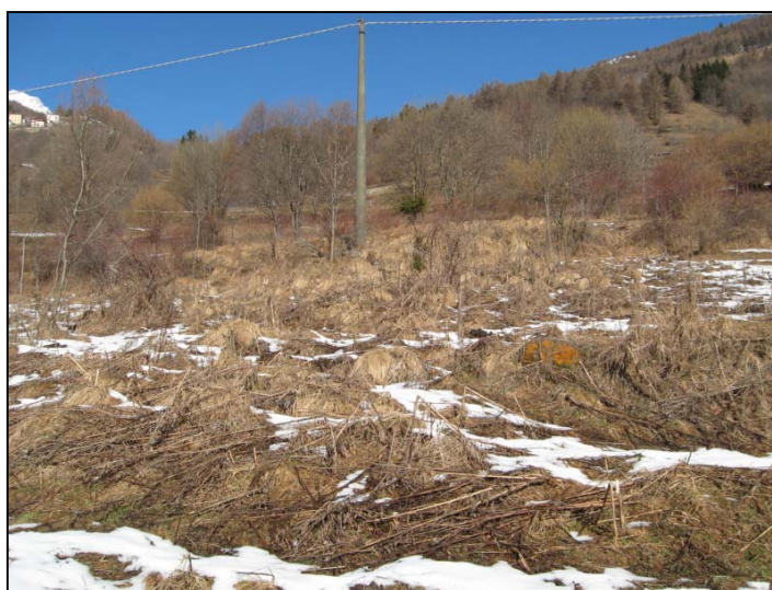
Fotografia 29 – Vista del pendio a nord di Via Dante caratterizzato da terreno mosso e instabile per la presenza di emergenze e ristagni d'acqua, potenzialmente in dissesto.
